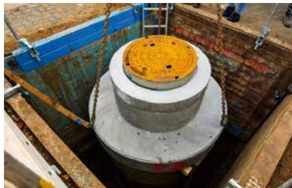
Für den Einbau von Abscheideranlagen gelten strenge Anforderungen
