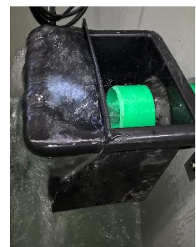
Abbildung 19 Drosselement im Betrieb
